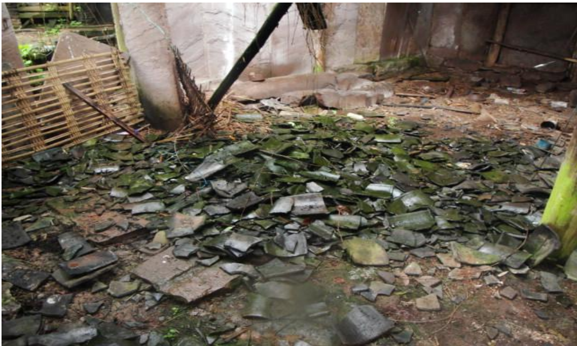
写真4 (重慶) 5村8隊(陳氏) 四合院西廂房の煉瓦が落ち、荒廃の光景が伺える。
